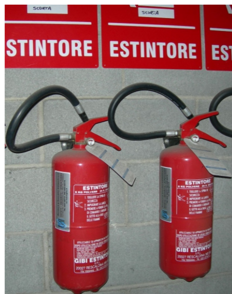
Foto 8: dispositivi antincendio con cartellino di controllo
